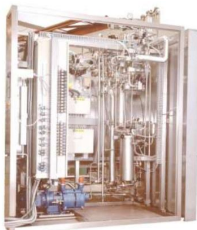
Figure 6. Exemple de zone technique.
