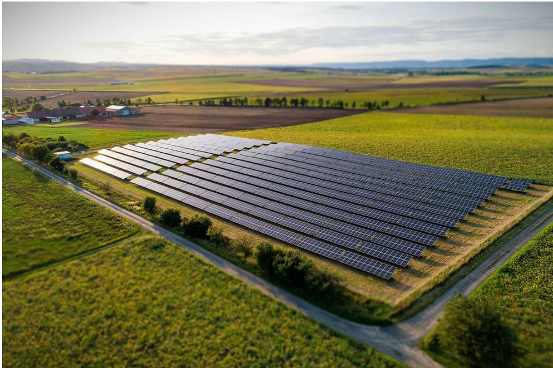
Figure F : Ferme photovoltaïque de la taille d'un hectare (Source : https://www.solairepro.comparateur-panneau-solaire.fr/que-represente-1-hectare/ )
