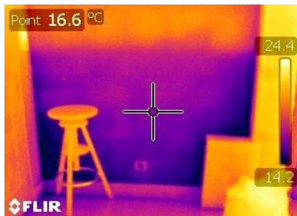
Figure 6 : Humidité dans le bâtiment, image en caméra thermique
