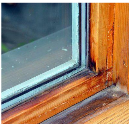
Figure 5 : Exemple trace d'humidité sur menuiserie
