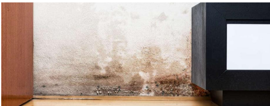
Figure 4 : Exemple de traces d'humidité
