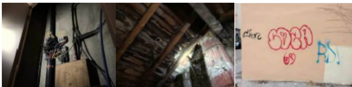
Figure 14 : Différents pathologies relevées : obligatoire : absence de cache de tableau électrique (à gauche), préventif : infiltrations d'eau en toiture (au centre), amélioration : présence de graffiti en façade (à droite), Source : Relevés PPPT
