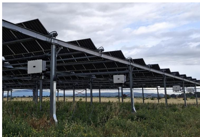
Figure 55 : Onduleurs de La Domègue B
