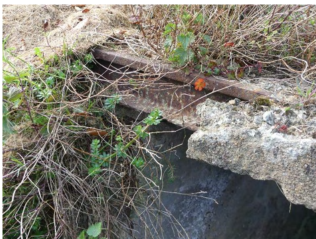
Figure 81 - Dégradation OH3_03 du Tablier
