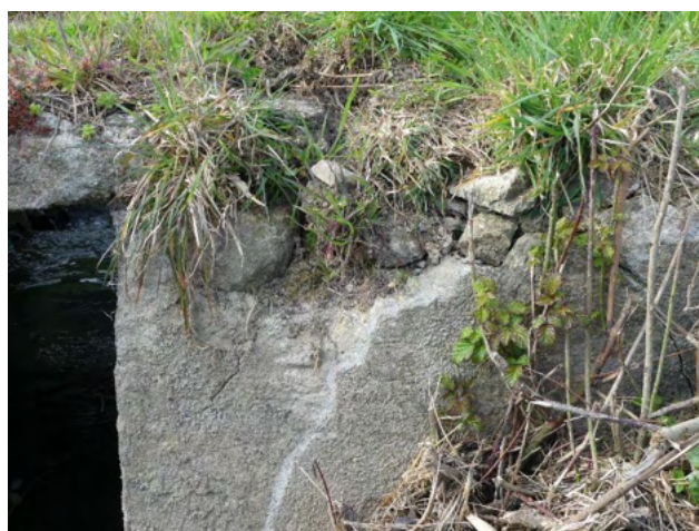
Figure 80 - Dégradation OH3_02 du Bajoyer RD
