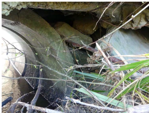
Figure 78 - Dégradation OH2_02 du Parement aval
