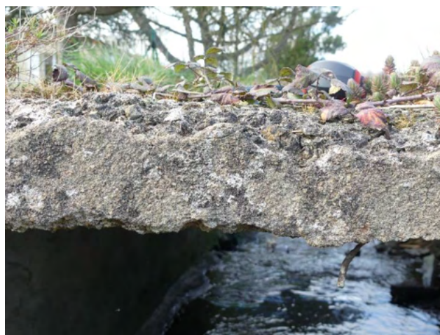
Figure 82 - Dégradation OH3_03 du Tablier
