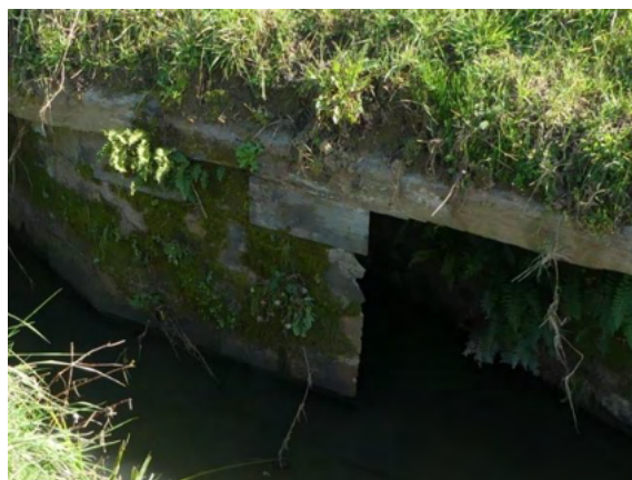
Figure 76 - Pile centrale présentant un biais important avec l'axe de l'ouvrage (18/03/2025)
