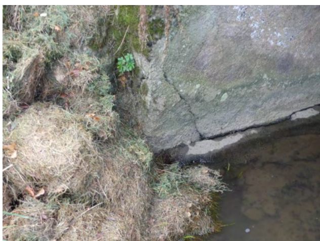
Figure 79 - Dégradation OH3_01 du Bajoyer RG
