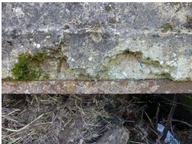
Figure 77 - Dégradation OH2_01 du Parement amont
