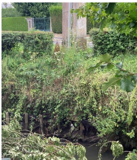
Figure 11: Photo d'ouvrage abîmé en aval du ru des Cordelins - juillet 2025 (source : Coralie)
