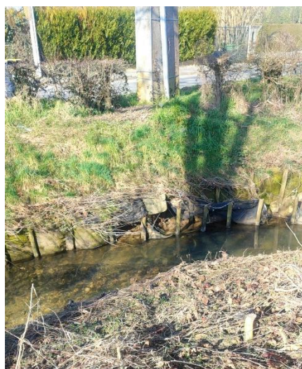
Figure 12 : Photo d'ouvrage abîmé en aval du ru des Cordelins - hiver 2025 (source : Rémi)
