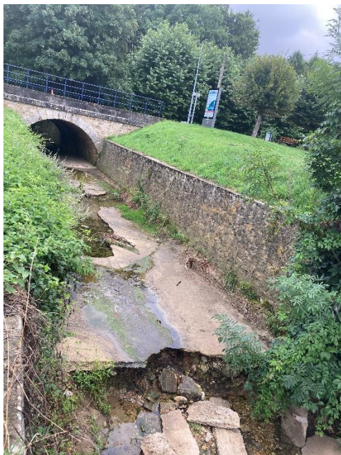
Figure 13 : Radier en très mauvais état du pont au niveau du Collège de la Ferté-Gaucher
