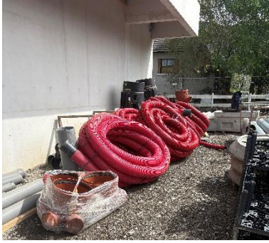
Figure 19 : Fourreaux électriques, Enzo GENNARO
