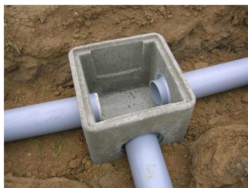
Figure 16 : Regard de branchement, Leroy Merlin
