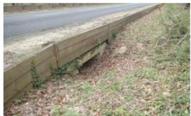
Figure 33: Dispositif permanent empêchant le passage sur la route et permettant la traversée sous la route (Source : A. Morand, CeremaEst)
