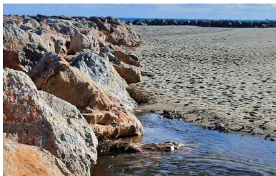
FIGURE 4 : PERCOLATION DES EAUX A TRAVERS L'OUVRAGE NORD OBSERVEE LE 03/11/23.
