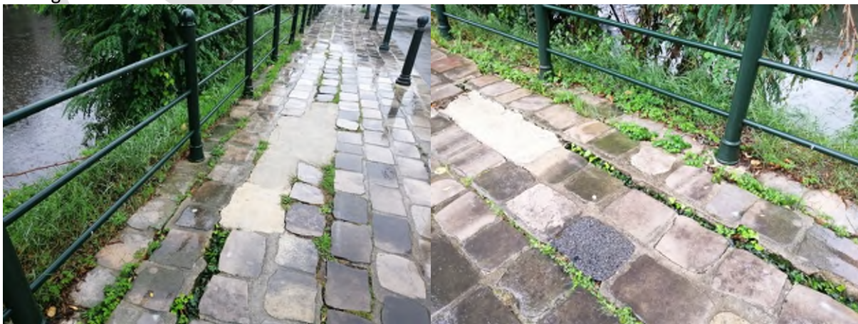
Figure 18 : Désordres observés sur le pavé en bord de berge
