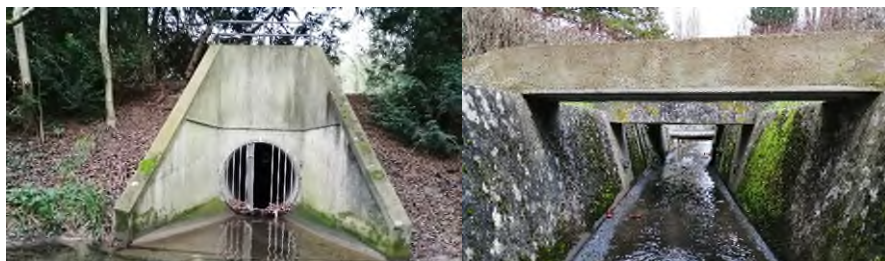
Figure 9 : Linéaire busé est canalisé sur la masse d'eau du Maldroit
