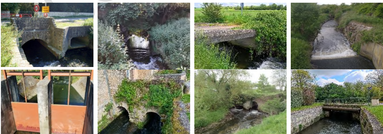
Figure 13 : Photographies prises sur le terrain des aménagements rompant la continuité écologique
