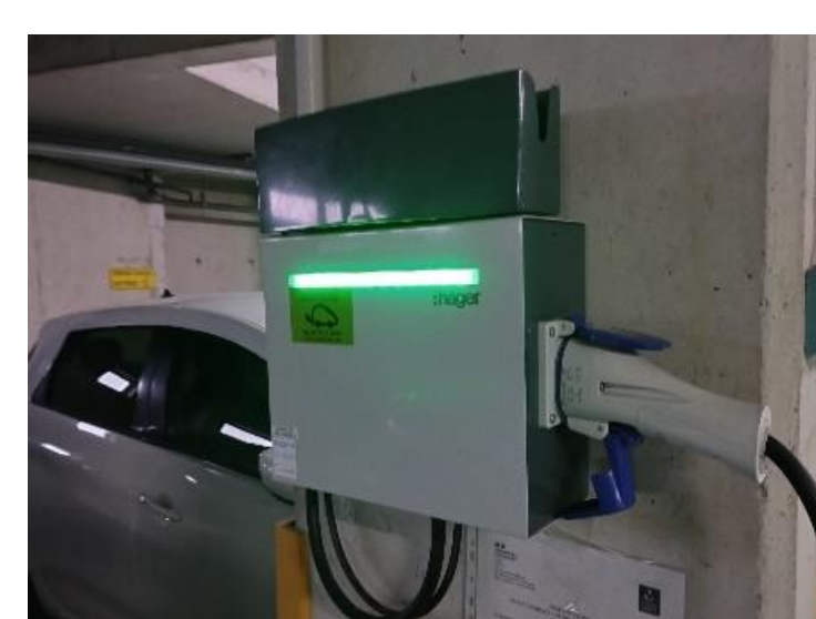
Bornes de recharge électriques
