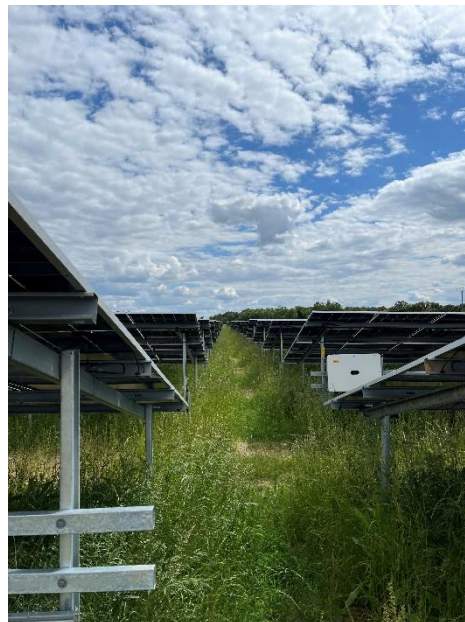
Figure 11 : Photo de la centrale au sol de Neuillé-Pont-Pierre (Martin SAUTEJEAU)
