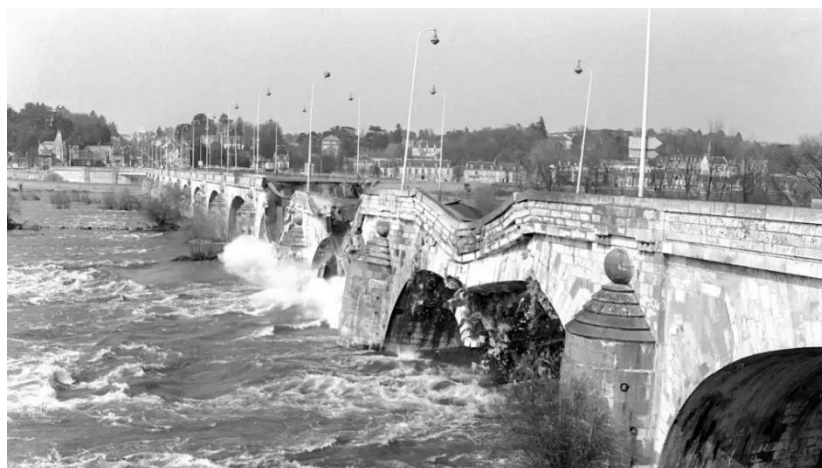
Figure 4 : Effondrement du Pont Wilson le 9 avril 1978 (Source : La Nouvelle République, Pierre Fitou)
