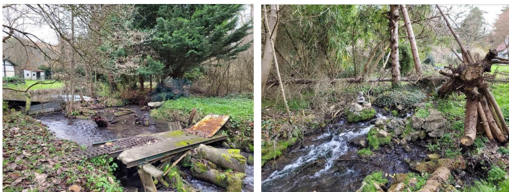
Figure 2. Ouvertures des brèches en rive gauche du bief du moulin des Clercs et aménagements de fortune
