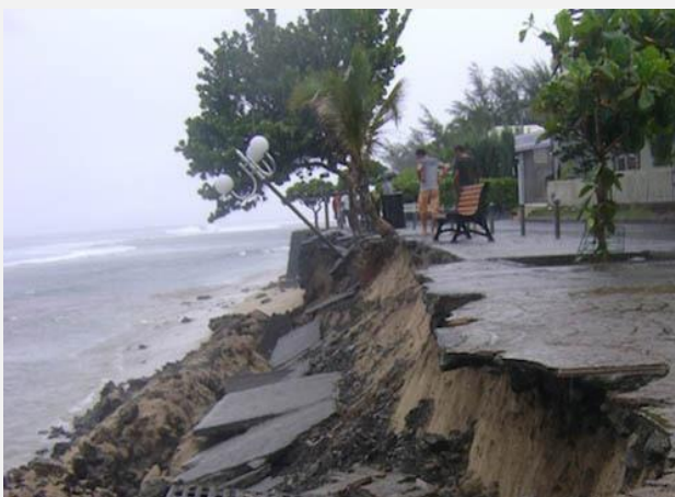
Effondrement esplanade Roches Noires, 12/2012 (source : RNMR)
