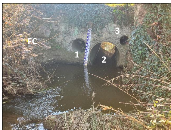
Figure 8 : buses circulaires à l'aval du marais Bodin
