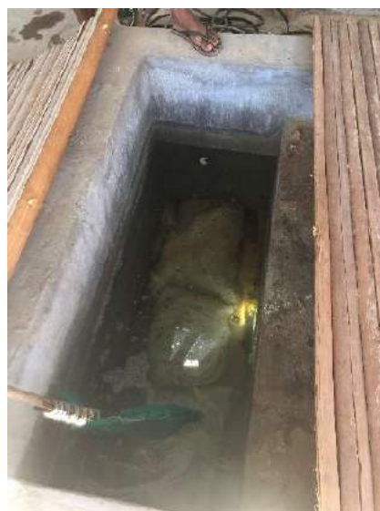
Figure 13 : Bassin annexe permettant la filtration de l'eau (source personnelle)
