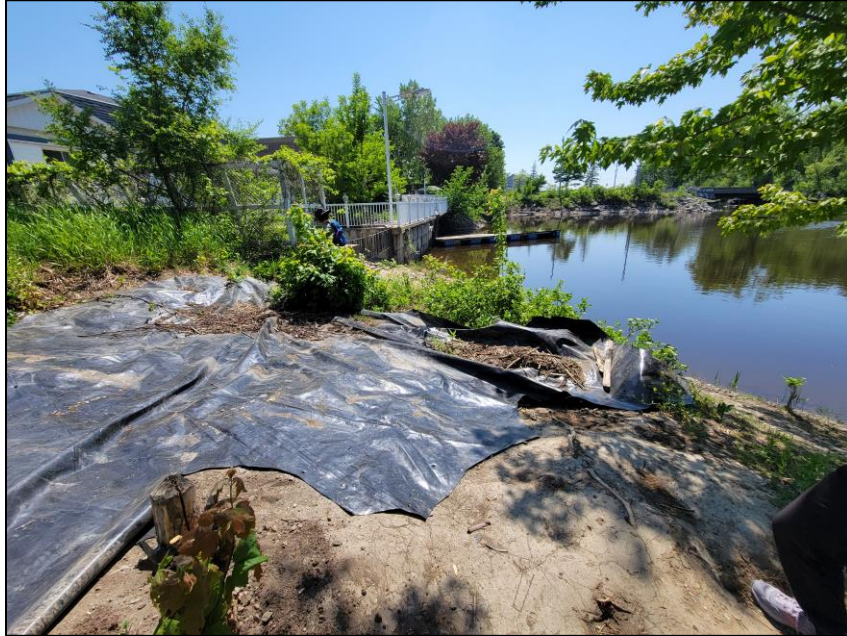
Figure 7 : Restant de la géomembrane secondaire du parc Ernest-Rouleau (©Mathias Moison)
