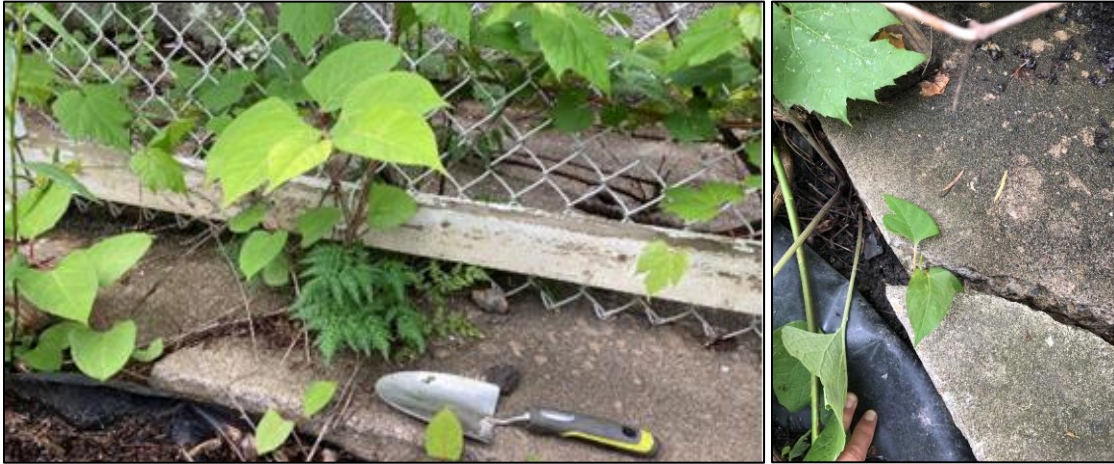
Figure 16 : Développement de repousses de renouée du Japon au niveau muret du béton (©Mathias Moison)
