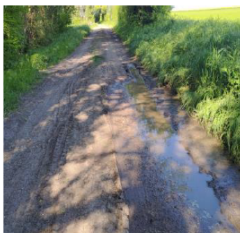
Chemin boueux inexploitable pour les cyclistes
