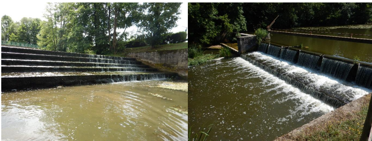
Figure 31: Illustrations du déversoir d'Abilly (à gauche) et du clapet de Chaumussay (à droite)
