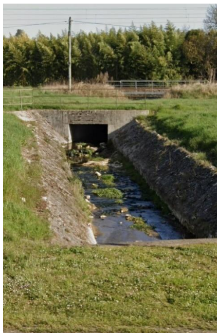
Figure 68 : Tuyau permettant la liaison entre le Battereau et le Filet (Source : Google maps)
