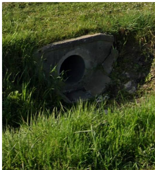
Figure 67 : Berges du Battereau colmatées avant la départementale (Source : Google maps)
