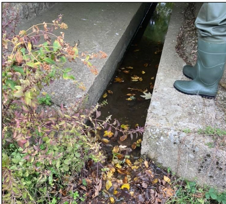
Figure 4.1.2.2 : Échancrure au niveau du pont "2" de la D145 (© A. Rougeyres)
