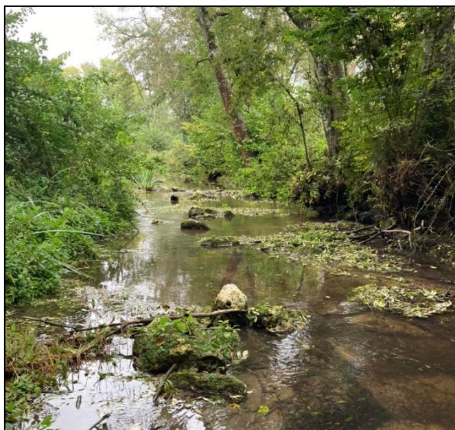
Figure 6.1 : Emprise de l’ancien plan d’eau de la vanne de Méré - travaux de diversification des écoulements (© A. Rougeyres)
