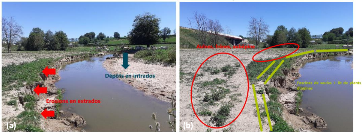
Figure 3: Problématique d'érosion diagnostiquée (a) et solution proposée dans le CR du 11 juillet 2022 (b)
