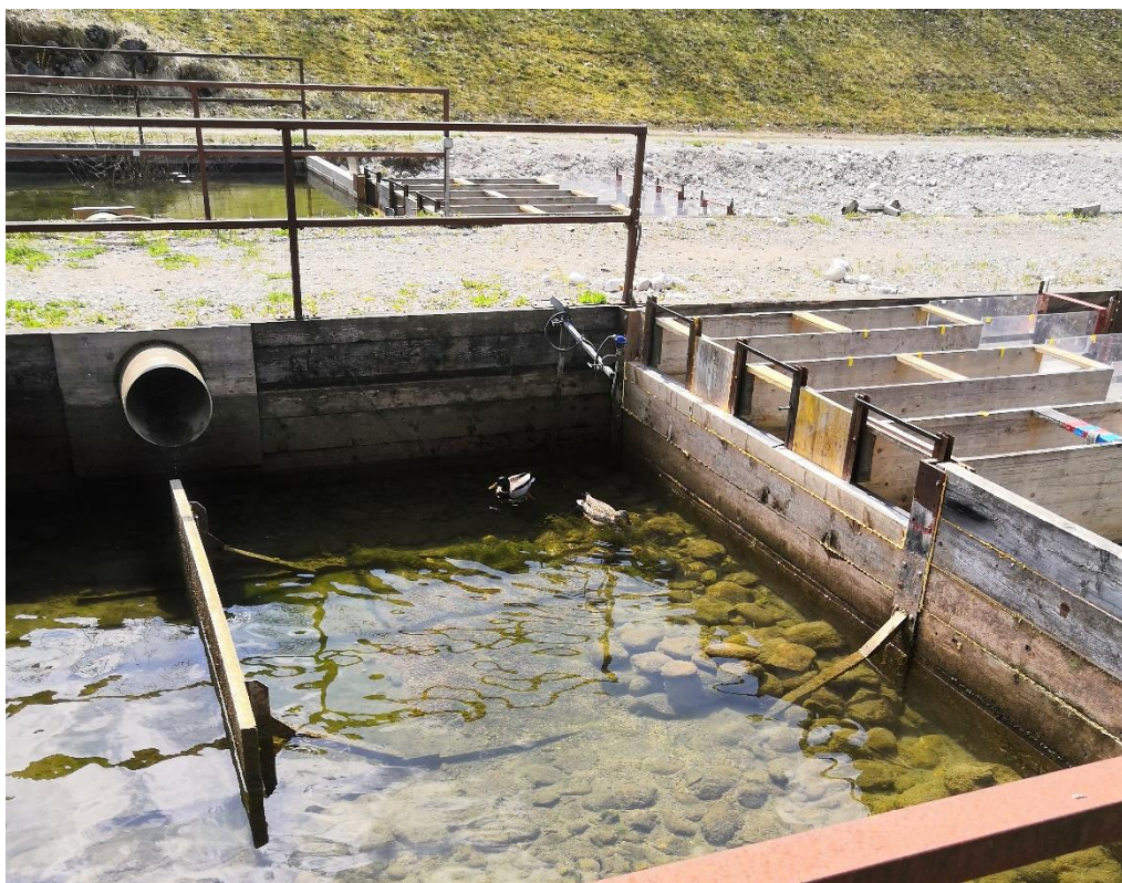
Figure 17 : Les deux bassins de mixage en vue latérale (drains d'alimentation non visibles)
