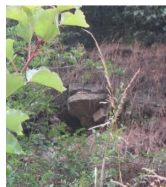
Figure 28 : Bloc fracturé surplombant la cour. Auteur : Antonin Dubois
