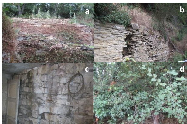
Figure 26 : vue du versant (a), perré instable avec bombement et trou (b), traces d'infiltration d'eau (c), perré submergé par la végétation (d). Auteur : Antonin Dubois
