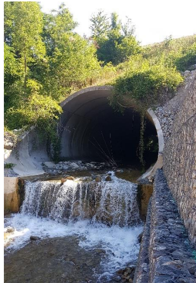
Figure 17 : Buse en béton sous la route Auteur : Angel Neuenschwander
