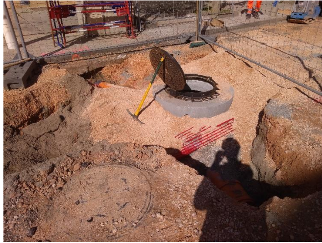
Photo n°9 : Un regard et ses branchements (photo personnelle)
