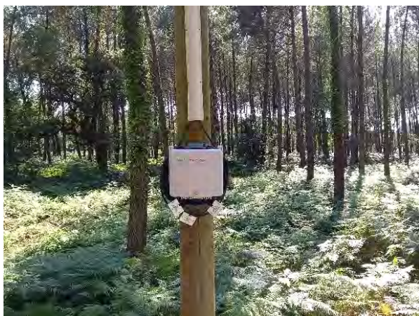
Figure 14 : PBO aérien sur appui bois
