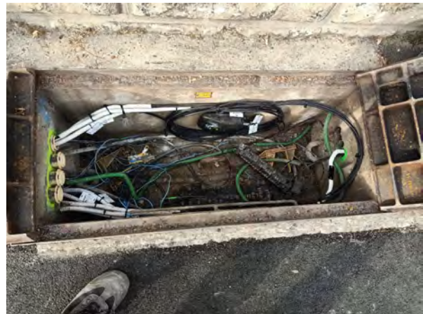
Figure 20 : Photographie d'une chambre télécom ouverte
