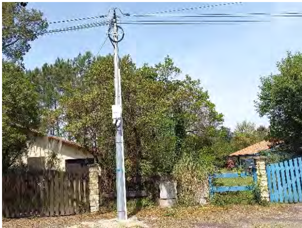
Figure 18 : Photographie d'un appui télécom
