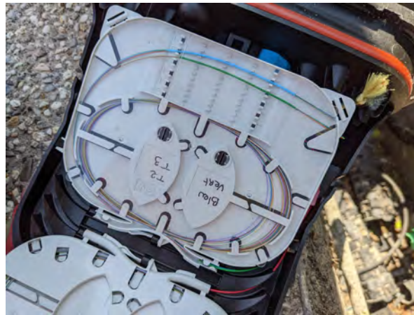
Figure 23 : Cassette pouvant accueillir 12 FO
