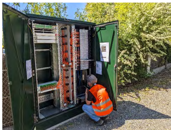
Figure 10 : Armoire de rue à Léon (Landes) pour un SRO
