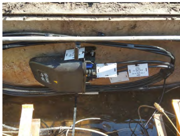
Figure 15 : PBO souterrain en chambre télécom
