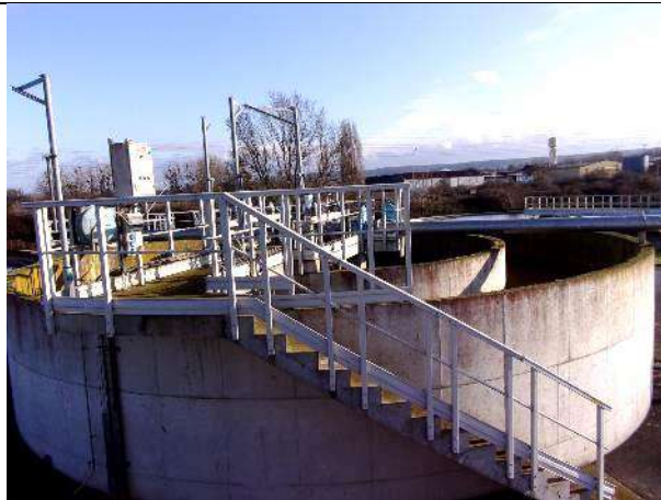
Bassin de répartition des eaux vers les deux files de traitement
