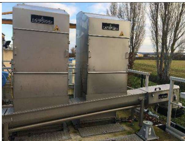
Dégrilleurs grossiers et compacteur des refus
