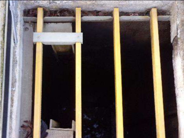
Trappe du regard amont, décollement de résine
