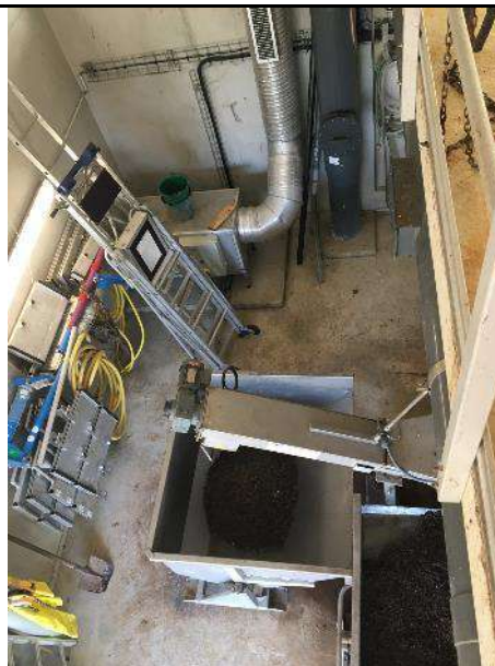
Bennes de stockage des sables
