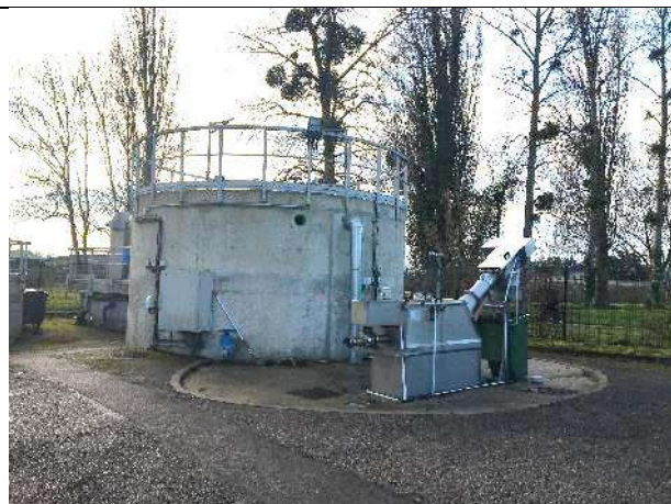
Préfasse de stockage des matières de vidanges sous dimensionnée, la préfasse ne permet pas de vidanger efficacement un camion et doit être partiellement vidée en milieu de vidange afin de pouvoir admettre la totalité des matières de vidanges.
