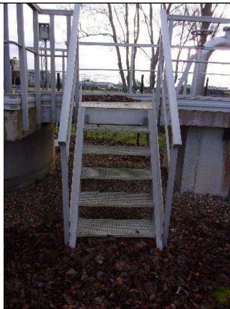
Pour accéder aux dégrilleurs grossiers, les marches sont glissantes, en contre-pente et très "souples".
