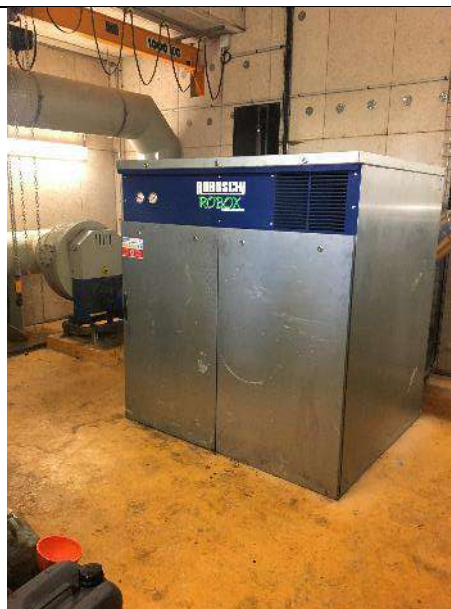
Un des surpresseurs file 2, avec au fond un ventilateur de désodorisation
