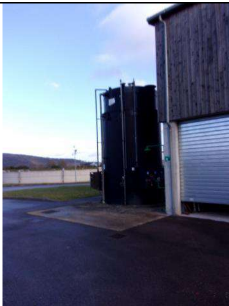
Cuve de stockage du chlorure ferrique
