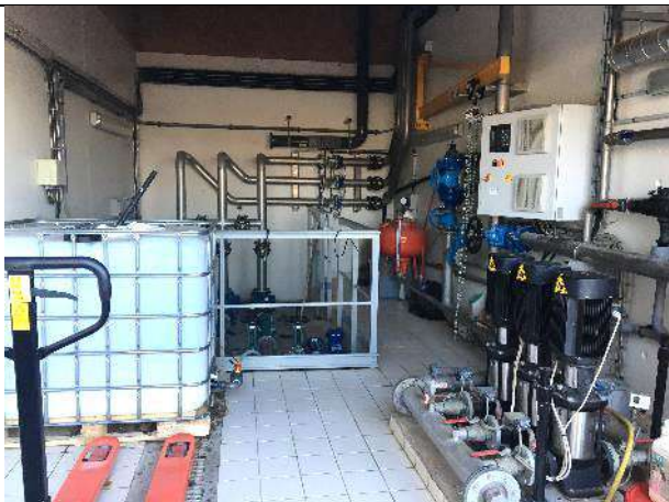
Cuve de stockage des polymères (à gauche) et surpresseurs d'eau industrielle (à droite)
