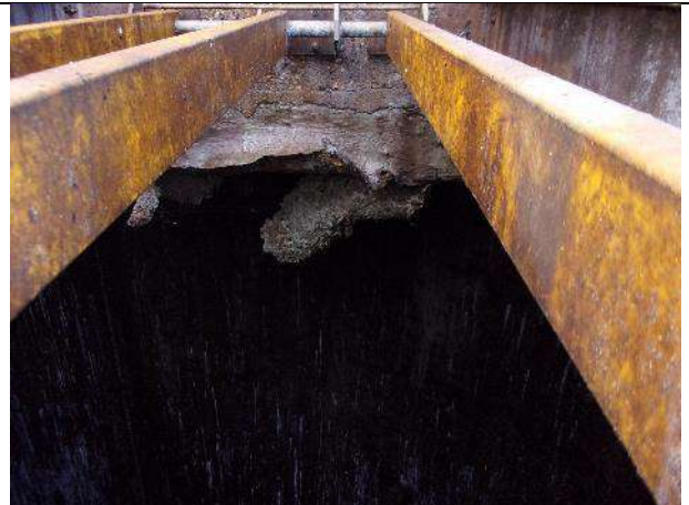
Intérieur du poste de relèvement Morceau de béton se détachant
