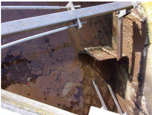
Usage prématuré des racloirs du dégazeur, mauvais réglage suspecté.
