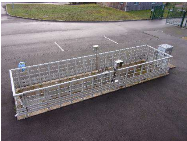
Canaux de comptage des eaux traitées avec préleveur réglementaire
