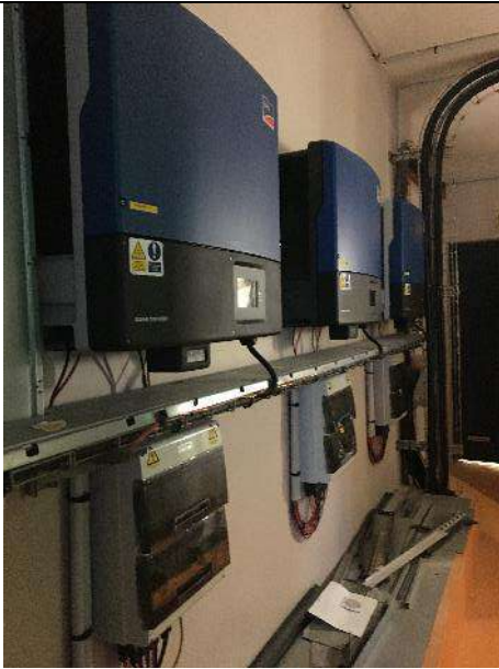
Onduleurs des panneaux photovoltaïques
