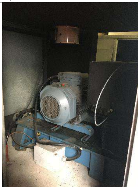
Surpresseurs file 1 décapotés. Le remplacement d'un des surpresseurs a été nécessaire en raison d'une surchauffe.
