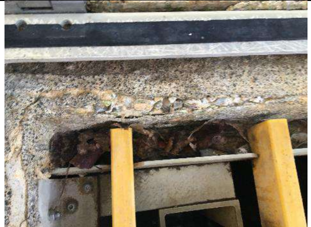
Trappe du regard amont, dégradation du béton
