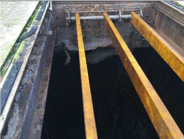
Trappe du poste de relèvement avec décollement de résine
