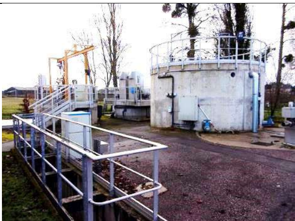
Premier plan : canal de comptage des eaux by-passées Second plan, de gauche à droite : poste de relèvement, dégrilleurs grossiers et cuve de stockage des matières de vidange
