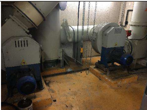
Ventilateurs de désodorisation
