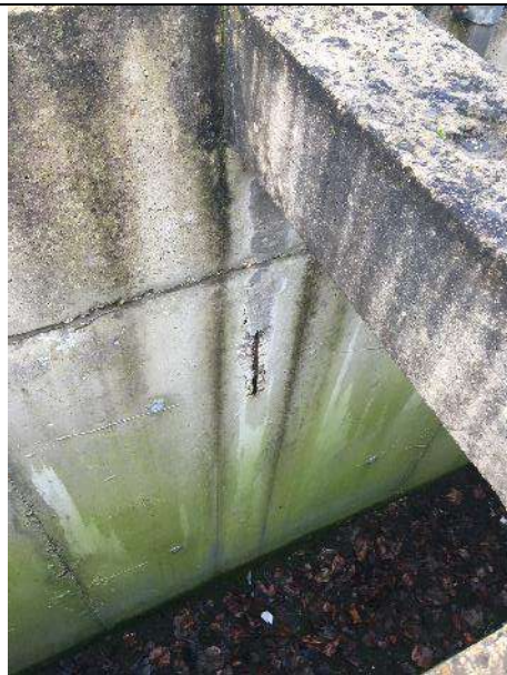
Canal de comptage du trop-plein rugueux et sale. Il ne permet pas une mesure fidèle du débit déversé.
