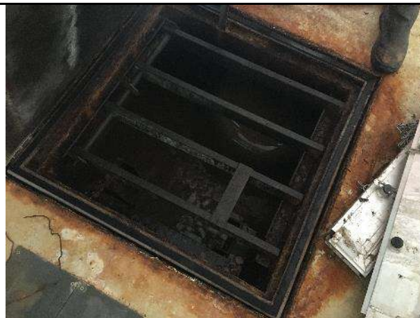
Trappe de l'étage des dégrilleurs fins, présence de corrosion
