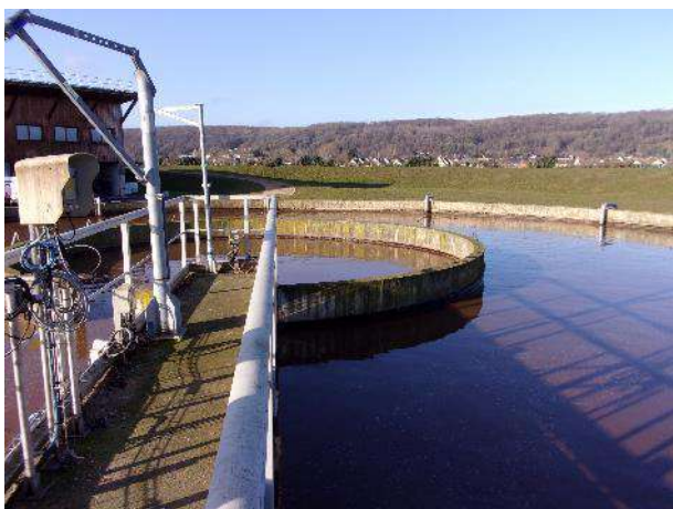
Bassin d'aération file 2
