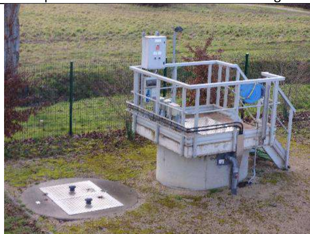
Poste de colature
