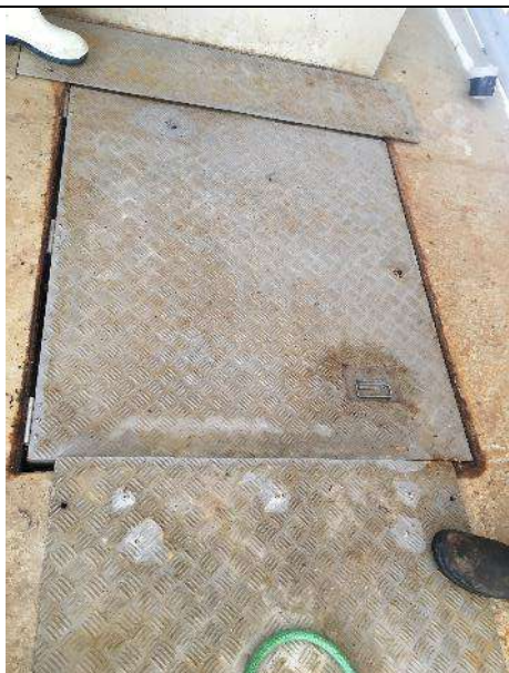
A l'étage des dégrilleurs fins, certaines trappes sont très "souples" et n'ont plus d'antichute.
