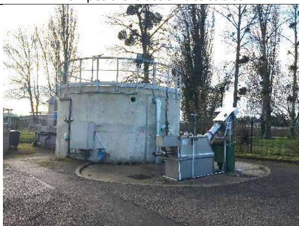
Cuve de réception des matières de vidange
