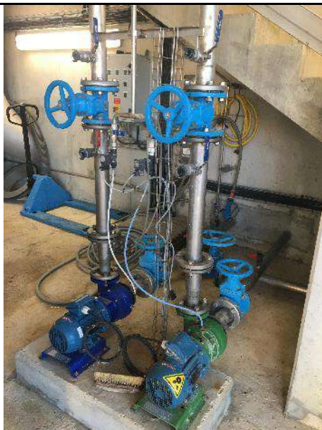
Pompes d'extraction des sables
