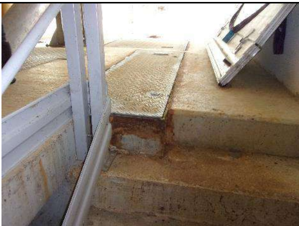
Traces de rouilles / dégradation du béton à l'étage des dégrilleurs fins.
