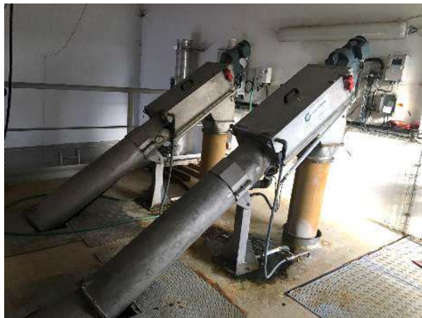
Deux dégrilleurs fins
