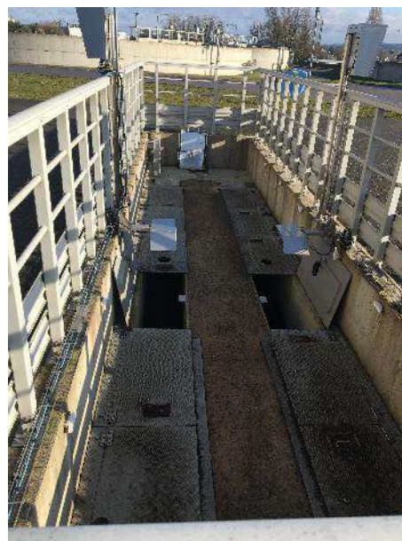
Canaux de comptage des eaux traitées
