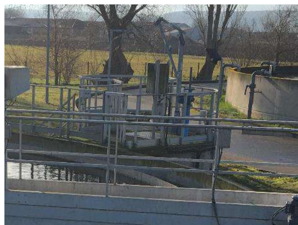
Puits de recirculation file 2
