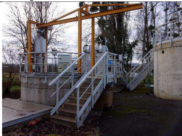
Vue d'ensemble du poste de relèvement avec préleveur
