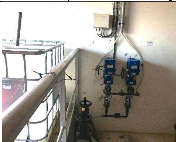
Pompes à polymère en position verticale
