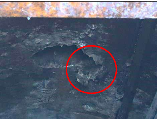
Intérieur du poste de relèvement Dégradation de la résine protectrice
