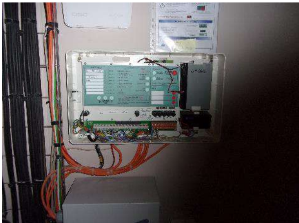
Coffret alarme incendie sans cache
