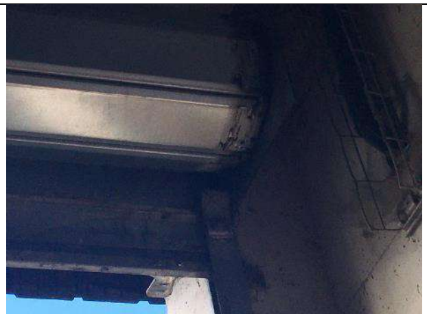
Porte à enroulement du local des dégrilleurs fins, moteur changé récemment et présence de corrosion.
