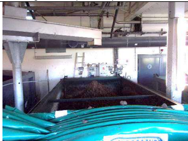
Répartiteur à boues et bennes de stockage
