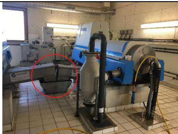
Centrifugeuses 1 et 2 En rouge : trémie pour récupération des boues
