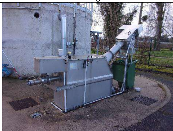
Dégrilleur grossier dédié aux matières de vidange
