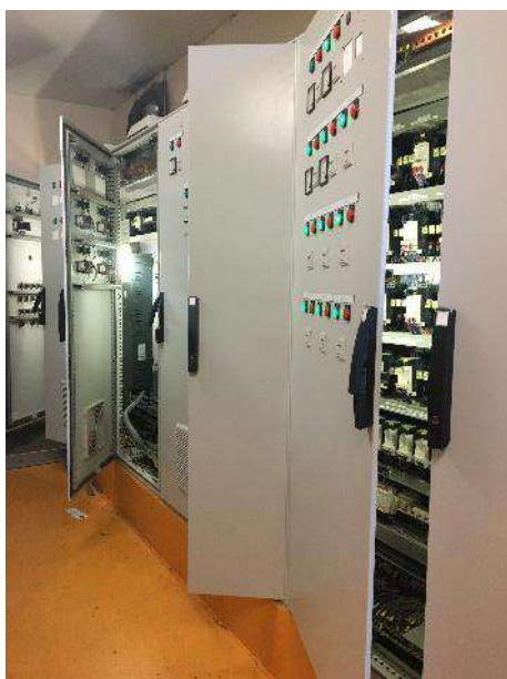
Armoires électriques ouvertes
