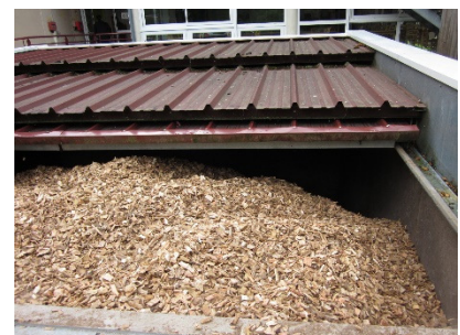
Figure 8 : Silo de stockage des plaquettes au CPA Lathus Source : photo Mathilde ALLERY
