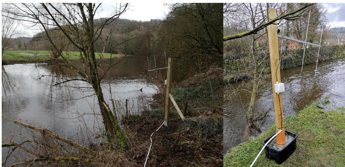
Antennes aériennes amont R09 (à gauche) et aval R10 (à droite)
