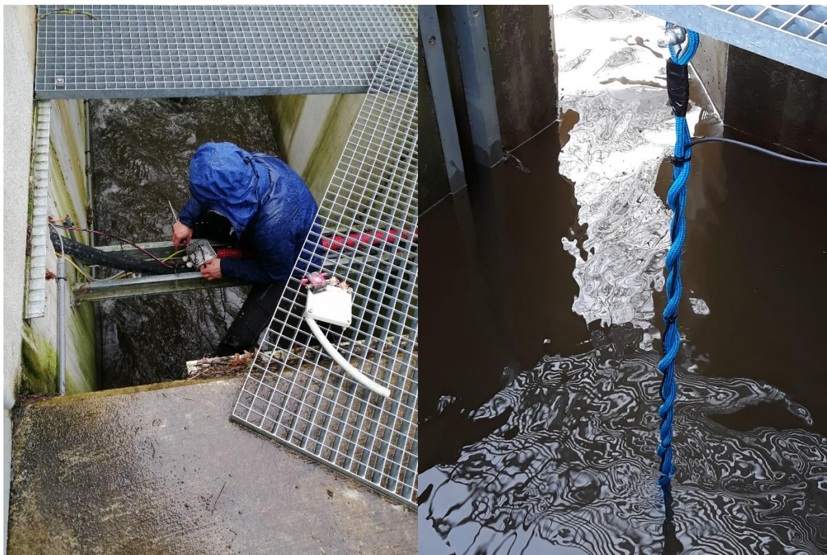
Système de 3 antennes subaquatiques dans la passe à poisson R03
