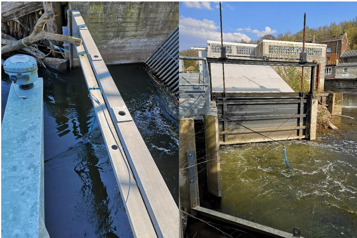
Antennes subaquatiques à l'entrée de la vis d'Archimède R02 (à gauche) et à la sortie R14 (à droite)
