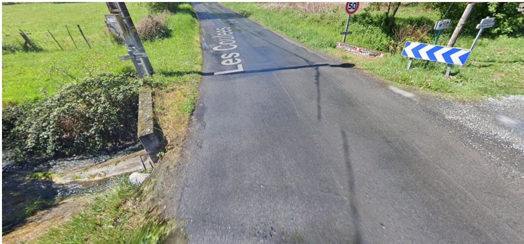
Figure 68: Buse de route passage de la « Rue de la fontaine sainte » près du hameau « La Cave »
