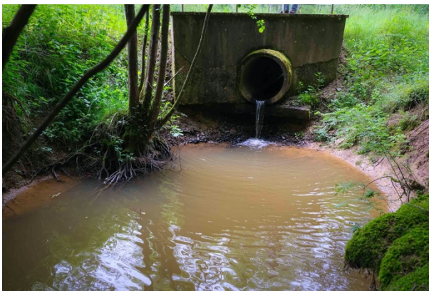
Figure 69: Érosion du lit d'un cours d'eau quelconque due à la dérive d'un courant d'eau à l'aide d'une buse routière. (THEISEN, 2019)
