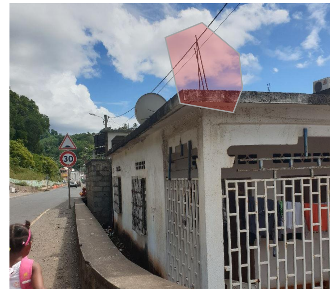
Figure 67 : Habitation présentant des aciers en attente sur sa toiture, 2019
