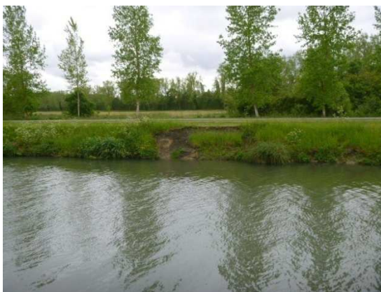
Figure 12 : Focus sur la présence d'érosion de berge
