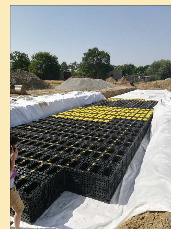
Structure de rétention alvéolaire
