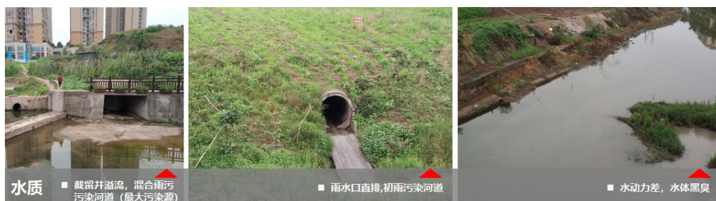
Figure 21, les eaux pluviales confondues avec les eaux usées
