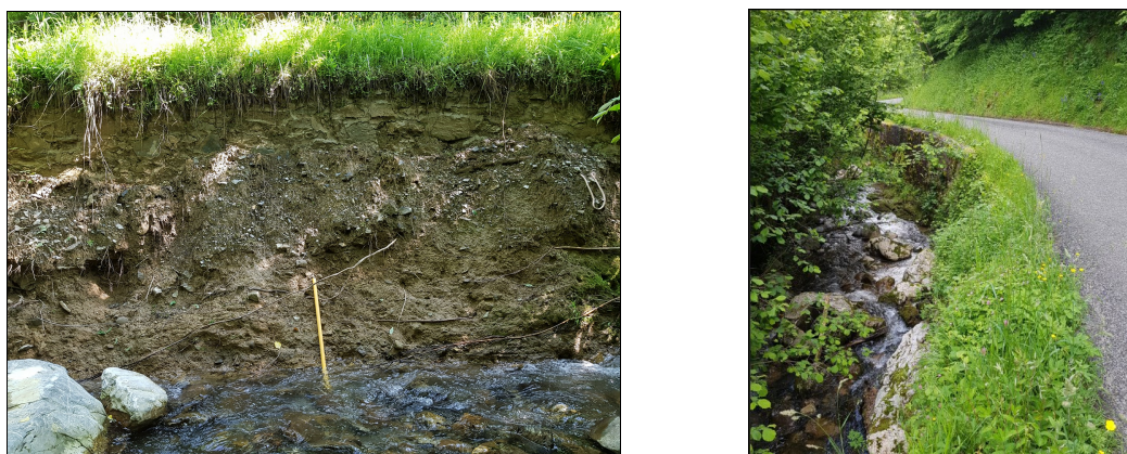
Figure 7 : Érosions à proximité de la route observées sur l'Espalungue (Source : Gaëlle JEAN)
