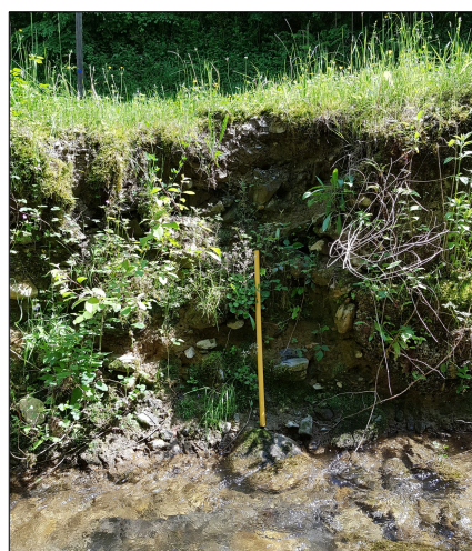
Figure 17 : Érosion proche de la route sur l'Espalungue (Source : Gaëlle JEAN)
