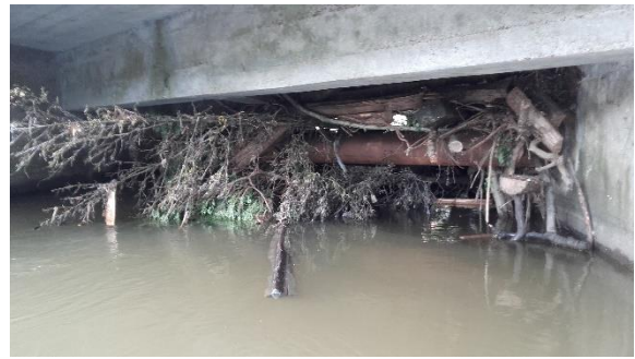
Figure 15 : Embâcles pont de Fricambault à Pithiviers le 10 juin 2016
