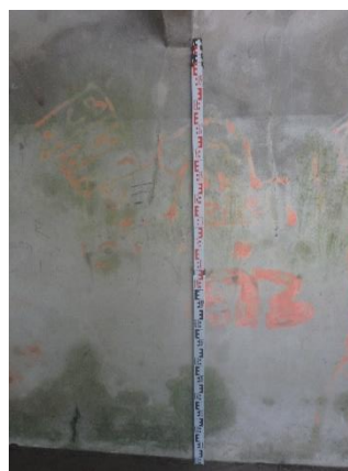
Figure 21 : Laisses de crues à Nancray-sur-Rimarde
