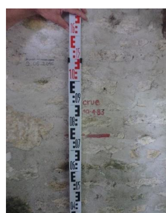
Figure 19 : Marqueurs de crue de 1983 et 2016 dans le lavoir d'Ondreville-sur-Essonne
