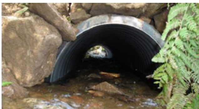
Figure 28 : Photo d'un hydrotube
