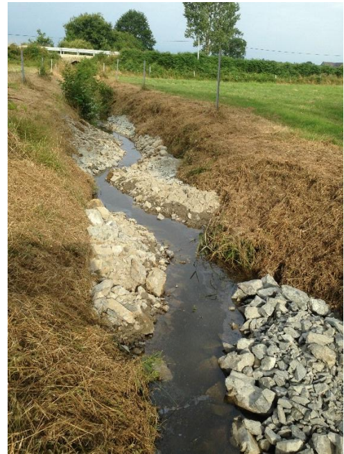
Figure 21 : Création de banquettes dans le lit mineur sur le Ruisseau de l'Etang (juillet 2018)
