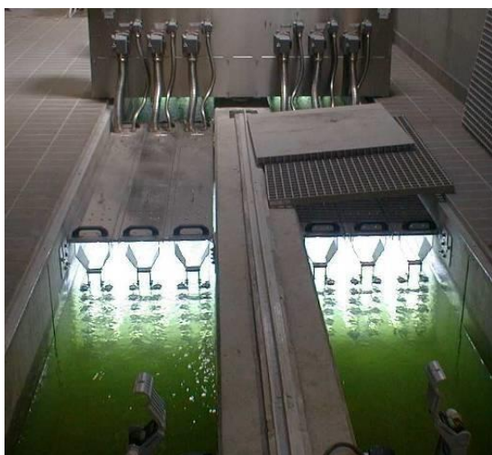
Figure 16 : Système de désinfection des eaux par lumières ultraviolettes. Source : Bavarian State Ministry of the Environment and Consumer Protection.
