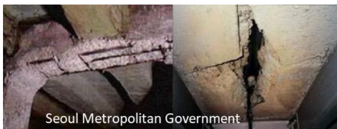
Figure 20 Piles de pont fragilisées
