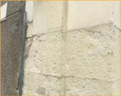
PHOTOGRAPHIE DES DESQUAMATIONS SUR PIERRES DE TUFFEAU
