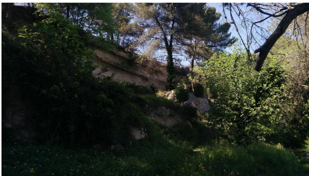
Photographie du flanc de la falaise en dessous du terrain, zone de glissement de terrain Source : Coline Montini
