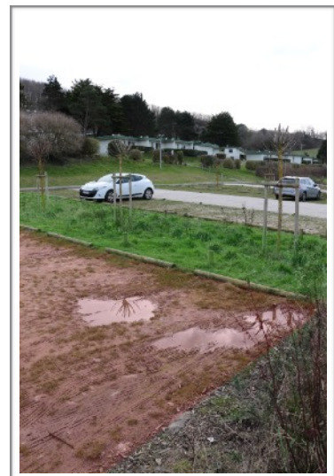
Figure 13 : En rouge, dégradation des surfaces végétalisées du parking 1.
