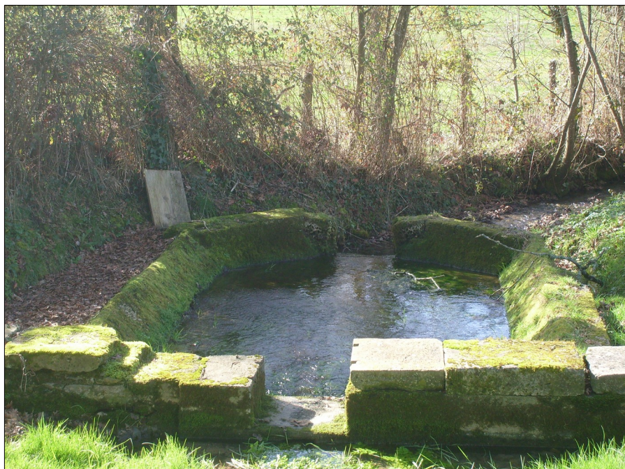
Figure 24 : Photo d'un lavoir avec développement de végétation (Source : Gaëlle JEAN)
