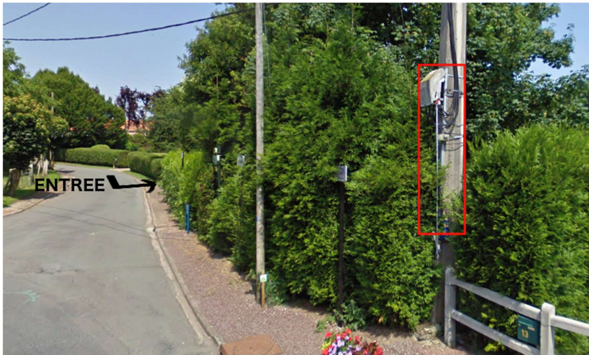
Figure 21 : Photo représentant l'entrée de la lagune et un transformateur électrique à sécuriser - Source : Google Street View
