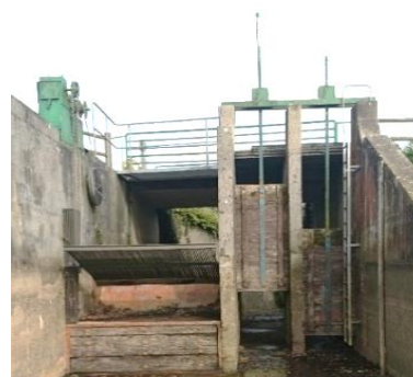
Figure 6 : Sortie d'eau par une grille réglable. Photographie M. Boderiou.
