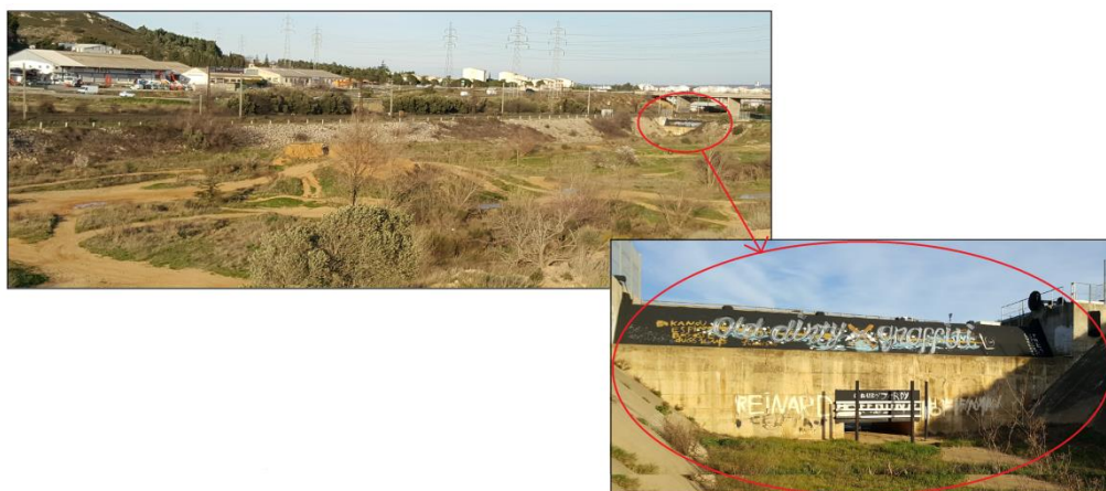
Figure 9 : Barrage de Cap de Pla à l'entrée de la ville de Narbonne (images personnelles)
