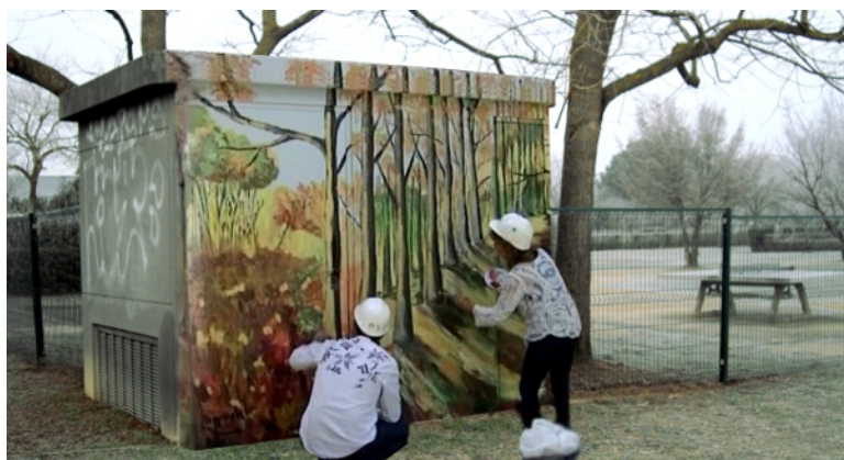
Illustration 19: Le transformateur électrique décoré
