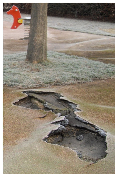
Illustration 14: Le sol dégradé de l'aire de jeux
