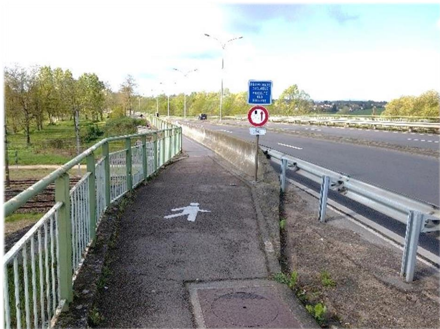
Rétrécissement de la voie cyclable avec barrière basse sur le pont SNCF sur la rocade (Photographie : Kévin DEBAETS)
